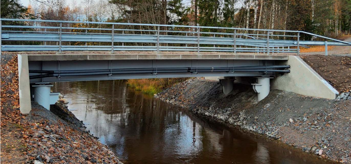
Bild 1 Balkbro av stål, betongdäck, samverkanskonstruktion. Bron har grundlagts på stölpålar av stål. Brons ändmurar och däckelement är av betong. På sidan av brobalken har man fäst jordkablar. Bron har typgodkända stålräcken..
