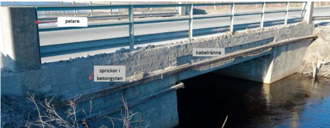
Bild 8 Bild på sprickor på en plattbro av betong i dåligt skick (på bilden en plattbro av betong med en öppning).
