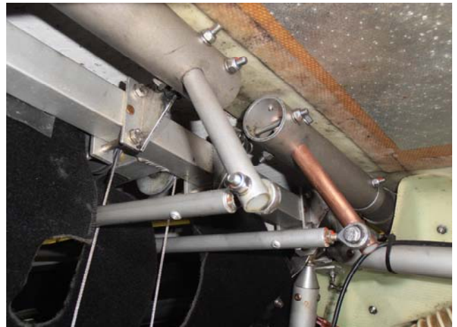
Pehmeästä vesijohtoputkesta valmistettu ohjainjärjestelmän kulmavipu on hengenvaarallinen.
