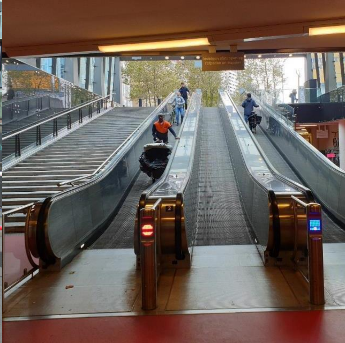
Kuva 13. Rotterdamin asemalla on liukukäytävät molempiin suuntiin. Keskimmäisen kuljettimen suunta vaihtuu ruuhkasuunnan mukaan.
